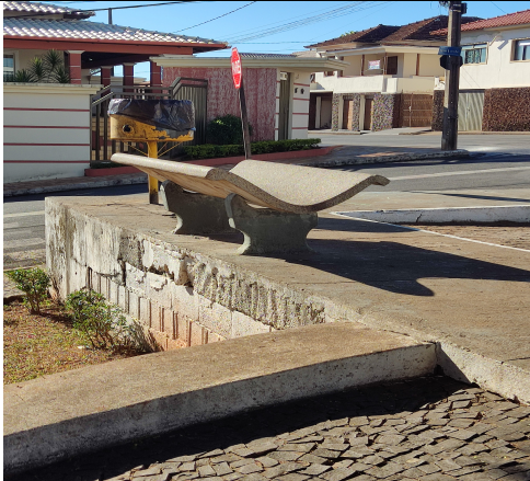
Foto 5: Banco desencaixado, evidenciando falta de alinhamento e possível risco de uso. Alex Alves Pereira, 27 jun. 2025.
