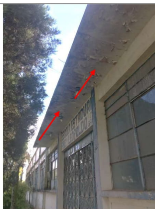
Foto 5: Problema de infiltração e desprendimento da camada pictórica. Camila Rodrigues, 05 ago. 2020.
