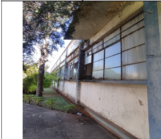
Foto 5: Vista parcial da fachada principal, evidenciando as janelas com vedações danificadas. Alex Alves Pereira, 27 jun. 2025.
