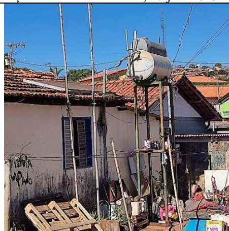
Foto 8: Aquecedor de água instalado próximo a uma edificação. Alex Alves Pereira, 27 jun. 2025.
