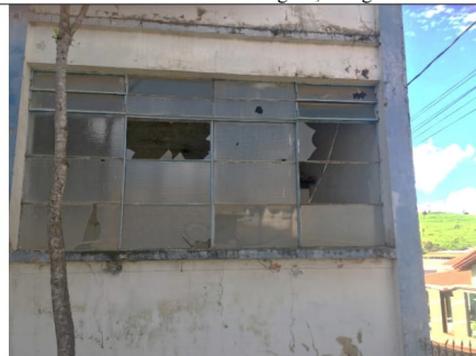
Foto 4: Janelas com peças de vedação em vidro quebradas, ação de vandalismo e trincas aparentes. Camila Rodrigues, 05 ago. 2020.
