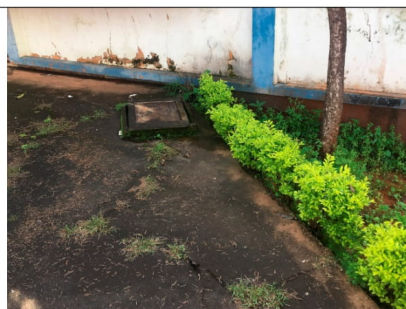
Foto 6: A umidade característica do terreno de implantação tende a ocorrência de infiltrações. Camila Rodrigues, 05 ago. 2020.
