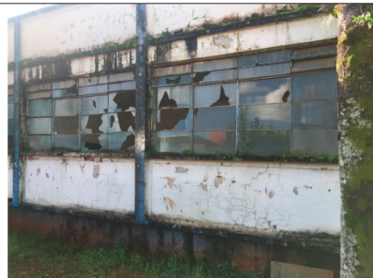
Foto 3: Janelas com peças de vedação em vidro quebradas, ação de vandalismo. Camila Rodrigues, 05 ago. 2020.
