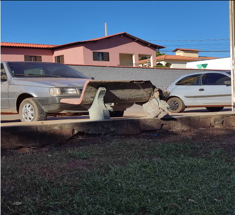
Foto 6: Banco da praça com danos expressivos, armação de concreto aparente e estrutura comprometida. Alex Alves Pereira, 27 jun. 2025.
